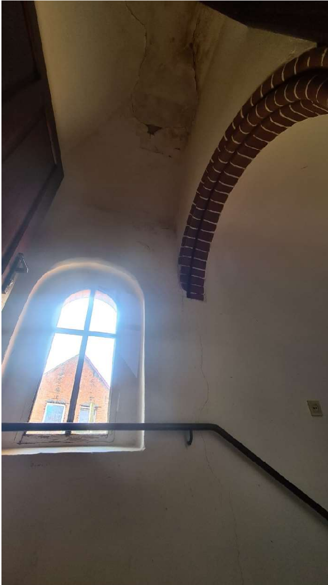
Fot.25. Widok zawilgoceń wewnątrz przybudówki powodowanych nieszczelnym pokryciem.
