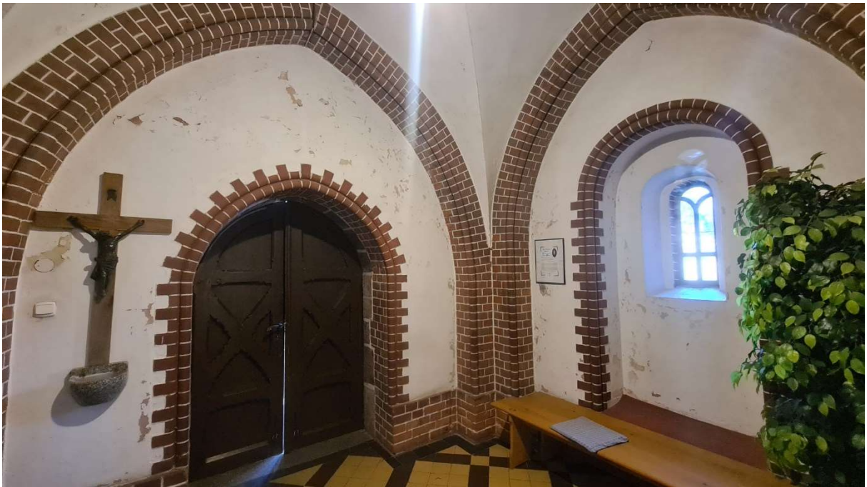
Fot.15. Widok łuszczących się powłok malarskich na skutek zawilgocenia murów przyziemia wewnątrz kruchty.
