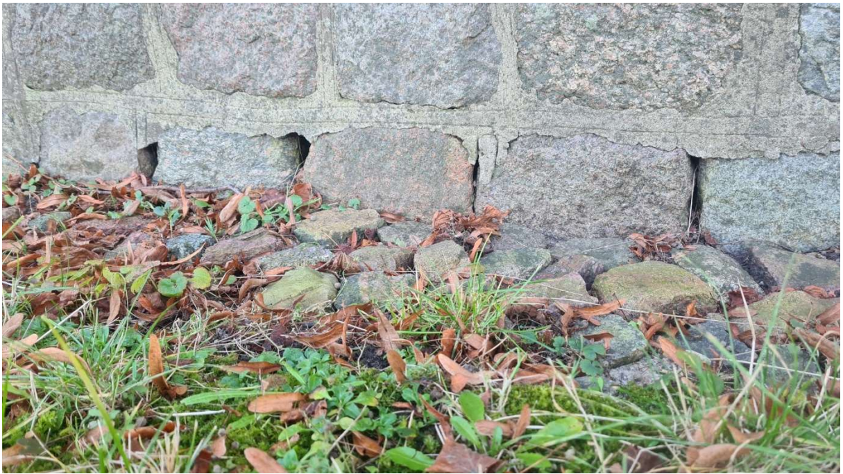
Fot.2. Widok zdegradowanych spoin w przyziemiu zachodniej ściany.
