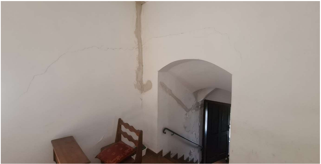
Fot.11. Widok rysy wewnątrz kościoła w narożniku południowo-wschodnim w poziomie empory.
