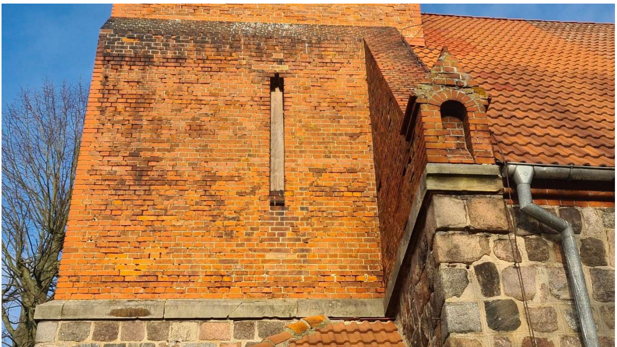
Fot.18. Widok uszkodzeń południowej ściany wieży.
