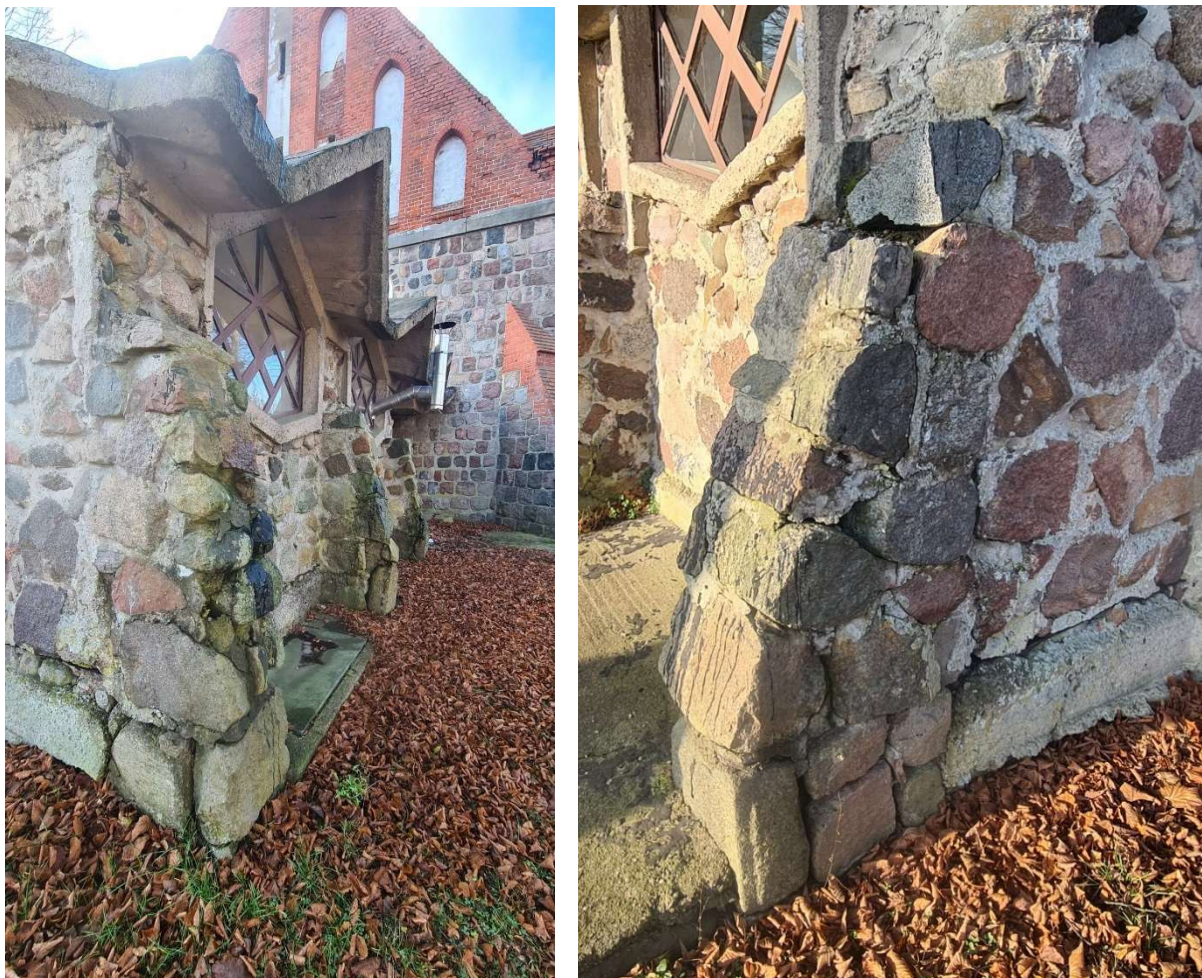
Fot.14. Widok uszkodzeń przypór zakrystii.
