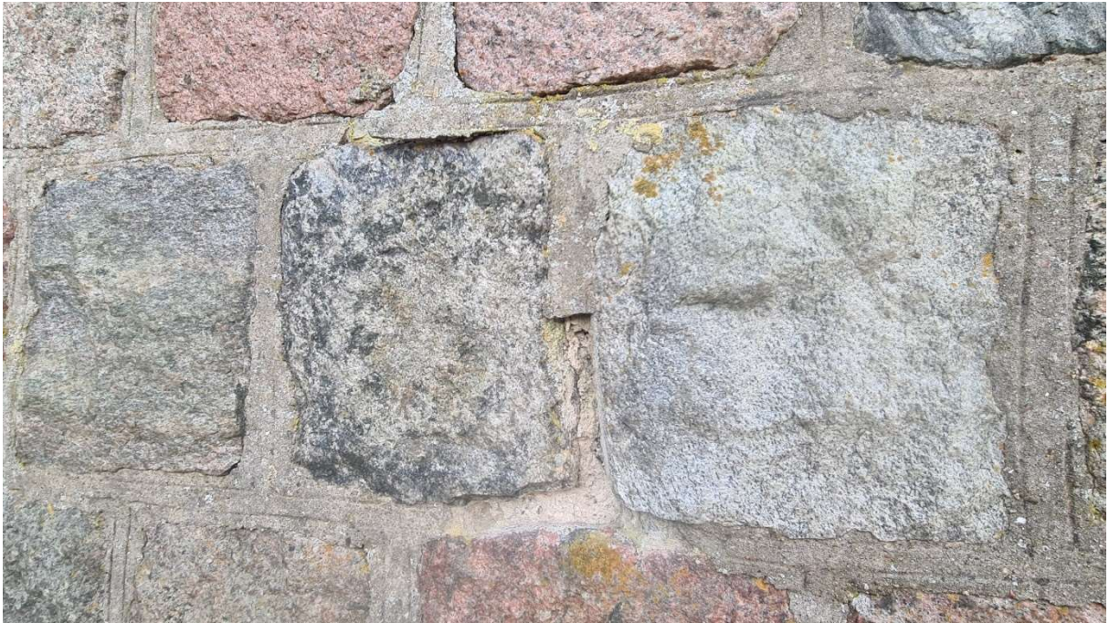
Fot.5. Widok zdegradowanych spoin w zachodniej części wieży.
