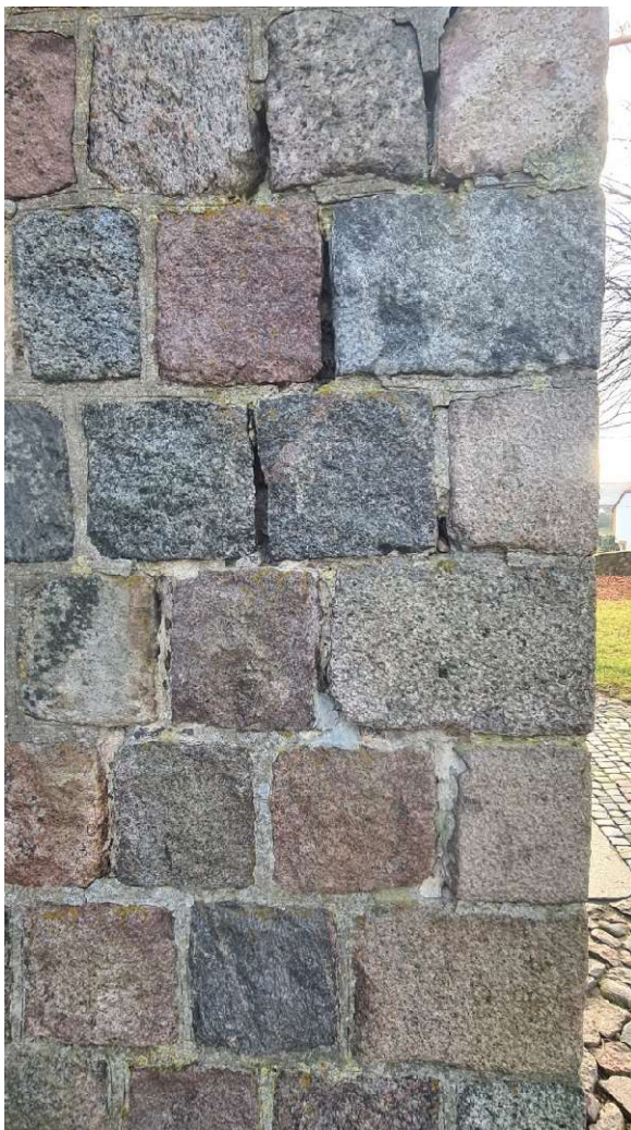
Fot.3. Widok zdegradowanych spoin zachodniej ścianie wieży.
