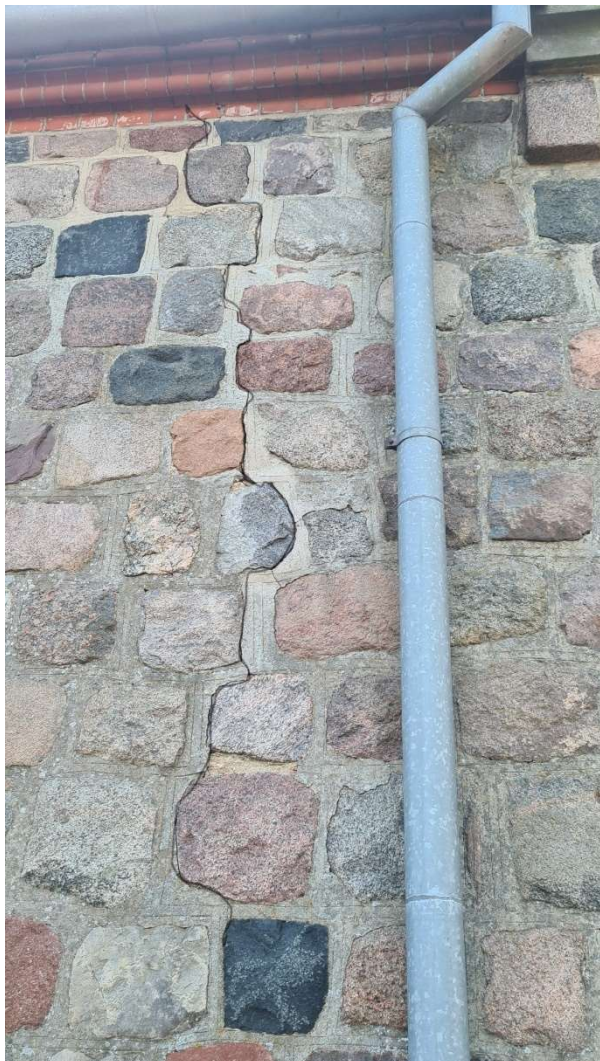
Fot.6. Widok pęknięcia w północnej podłużnej.
