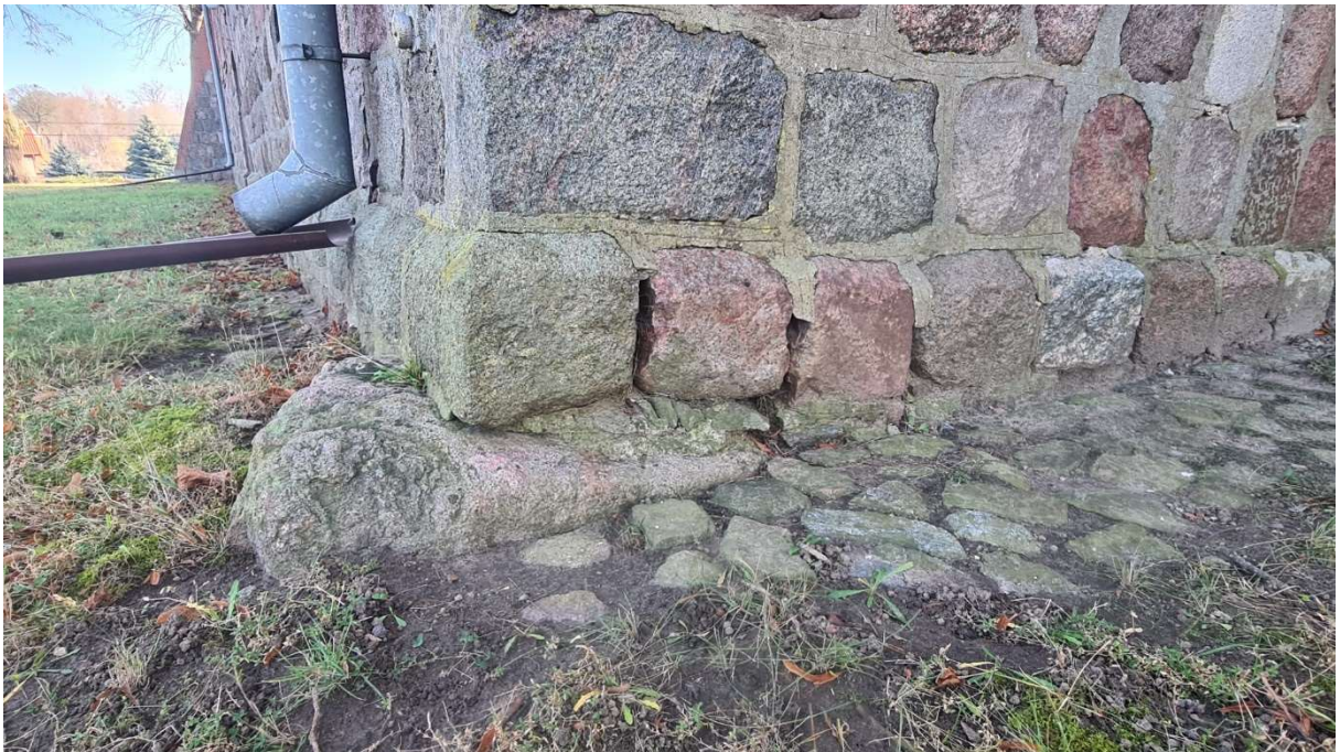
Fot.1. Widok południowo-zachodniego narożnika wieży z podstawą w formie głazu oraz zdegradowanych spoin warstwy elewacyjnej murów przyziemia.
