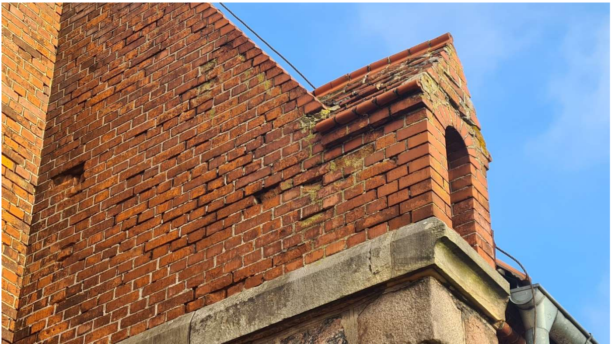
Fot.20. Widok uszkodzeń zachodniej ściany szczytowej.
