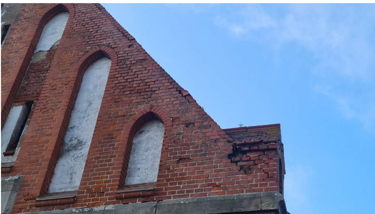
Fot.22. Widok uszkodzeń wschodniej ściany szczytowej.
