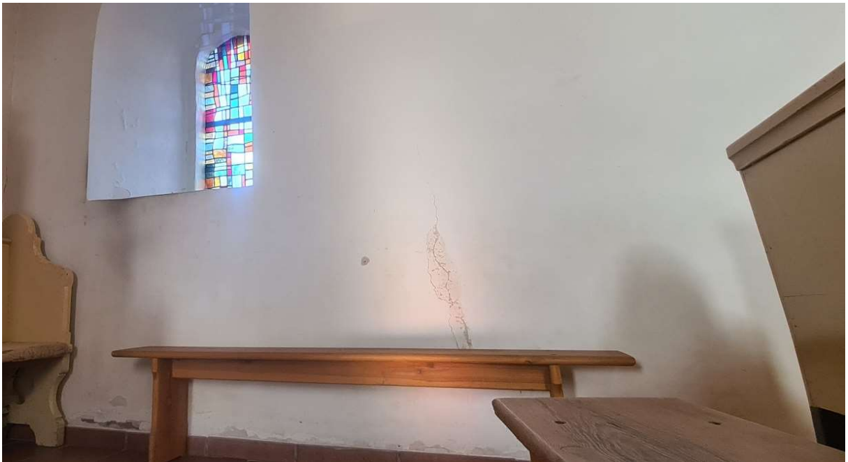
Fot.8. Widok rysy wewnątrz kościoła w poziomie przyziemia.
