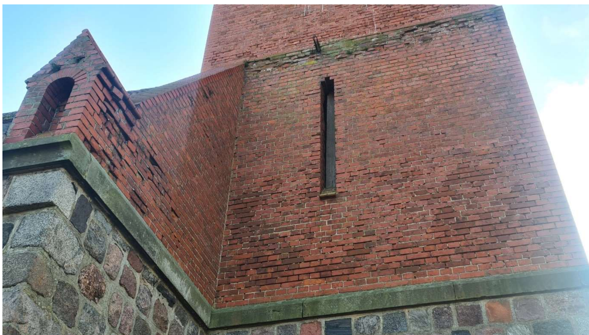
Fot.16. Widok uszkodzeń północnej ściany wieży i zachodniej ściany szczytowej nawy.
