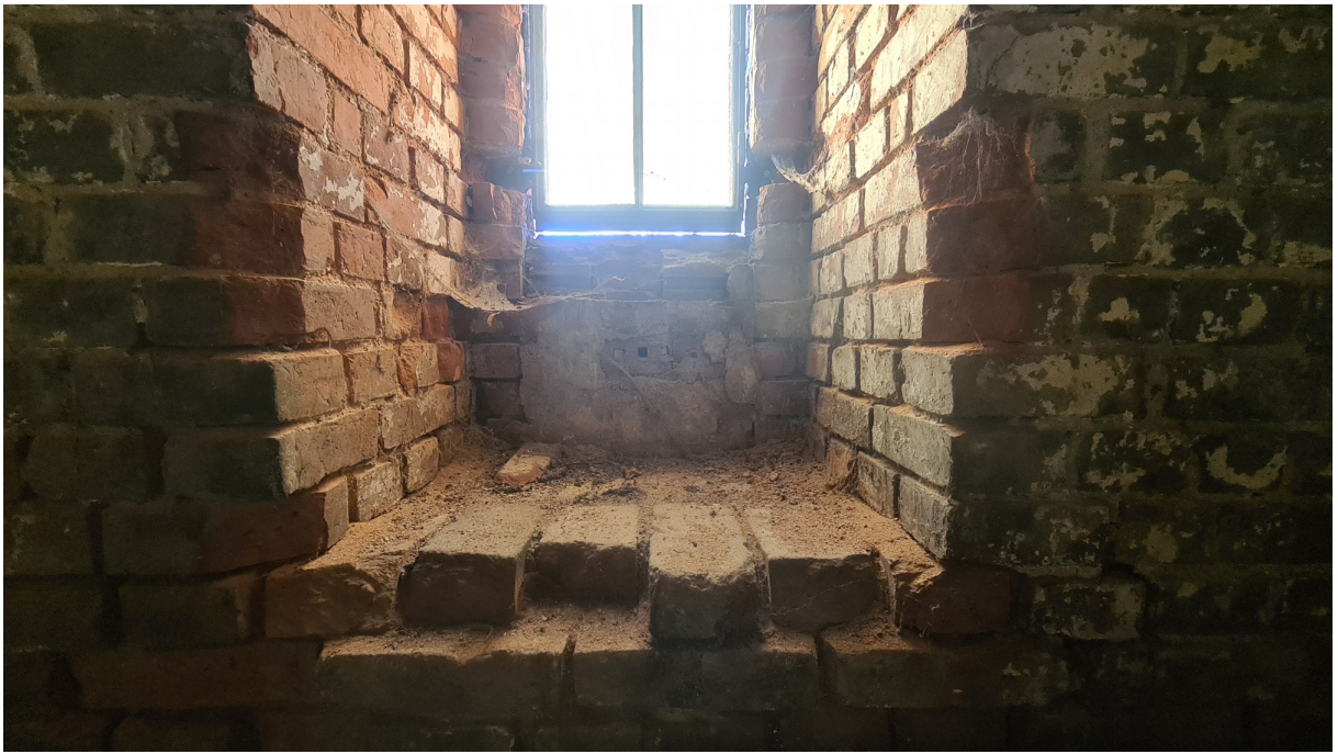
Fot.19. Widok zawilgoconej i zdegradowanej wnęki okiennej wewnątrz przestrzeni wierzy.
