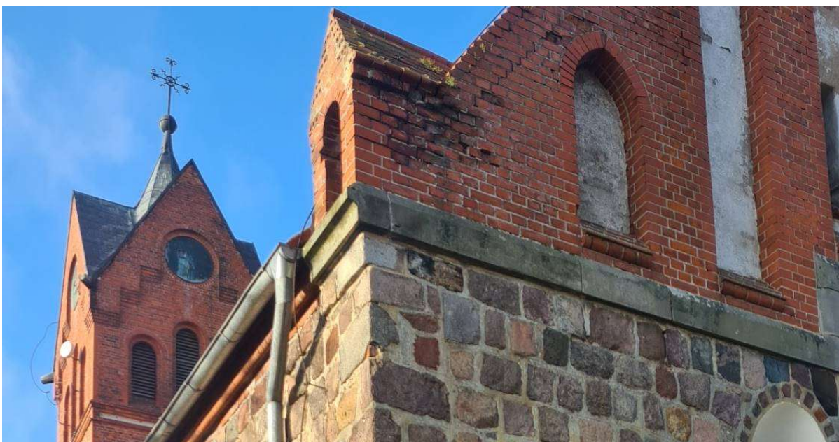
Fot.21. Widok uszkodzeń wschodniej ściany szczytowej.
