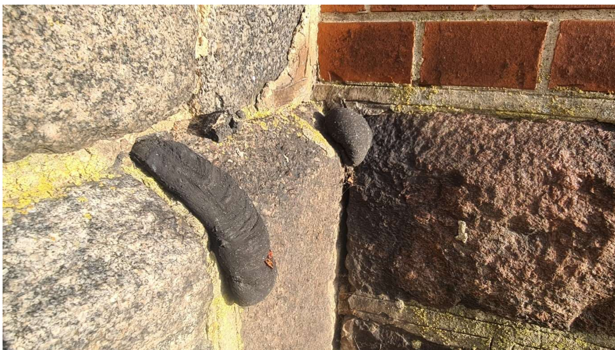
Fot.26. Widok wycieku masy bitumicznej.
