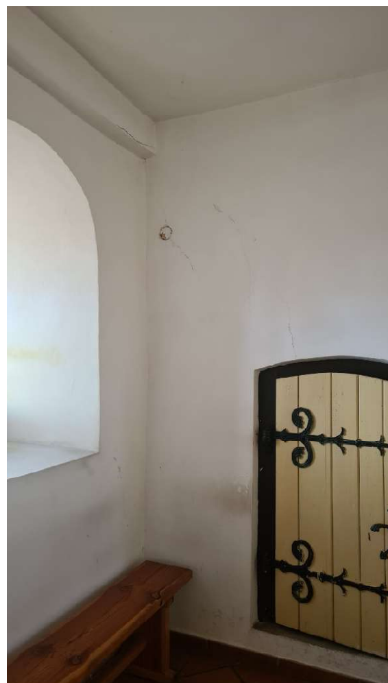
Fot.10. Widok rysy w narożniku południowo-wschodnim w poziomie przyziemia.
