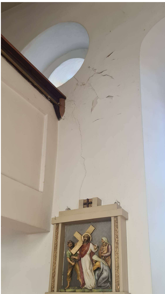
Fot.9. Widok rysy w północnej ścianie poziomie empyry.
