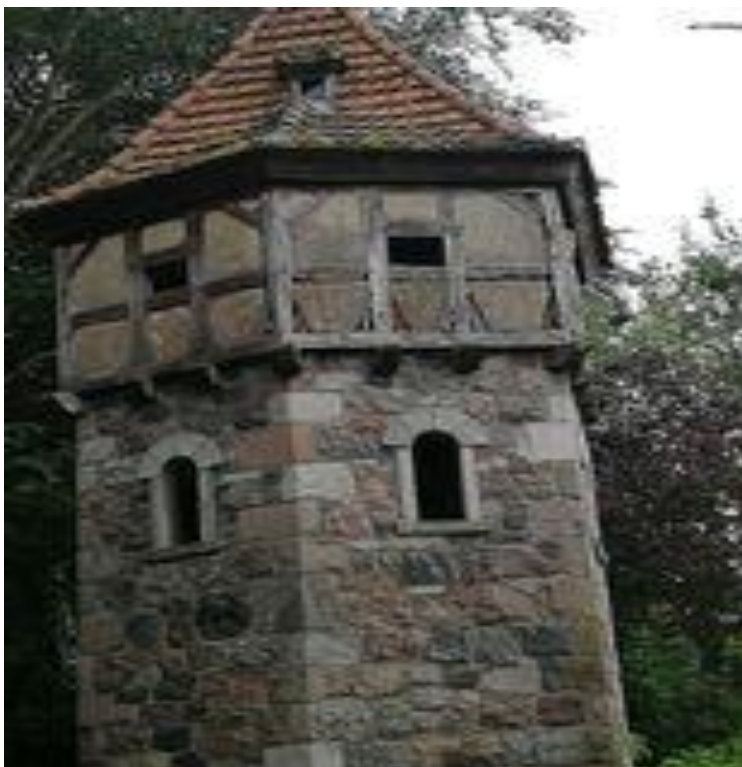
Zdjęcie 12. Niszcząca wieża widokowa w Gilowie.
